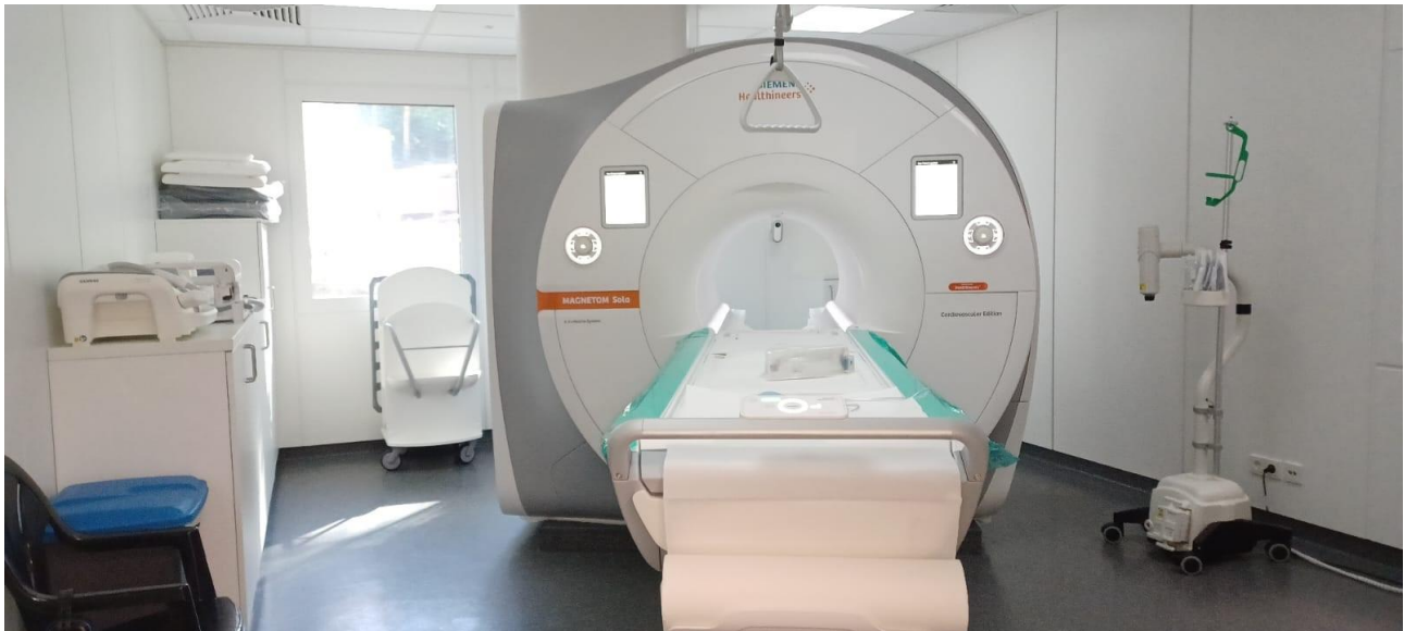
Bildunterschrift: Das neue MRT ‚Magnetom Sola CV‘ am St. Marien Hospital der GFO Kliniken Bonn
